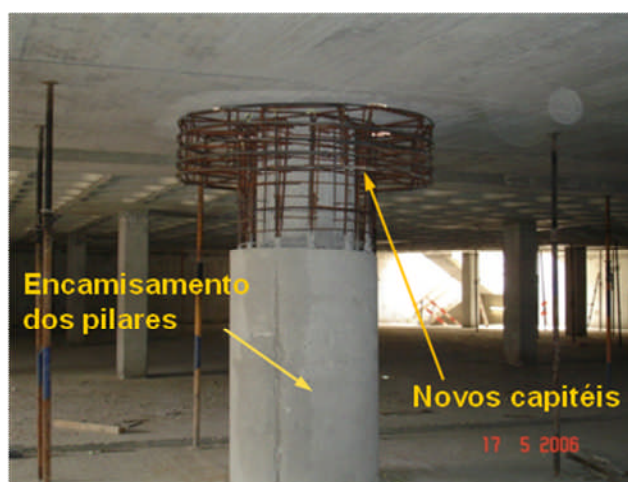
Fig. 11 – Reforço dos pilares de betão por encamisamento, e da laje ao punçoamento com capitéis em betão armado.
