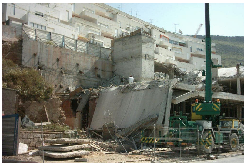
Fig. 3 - Colapso progressivo causado por erros de execução (num edifício em Portugal).
