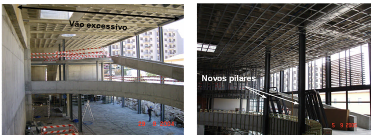
Fig. 13 - Reforço por alteração do sistema estrutural com a colocação de novos pilares metálicos.
