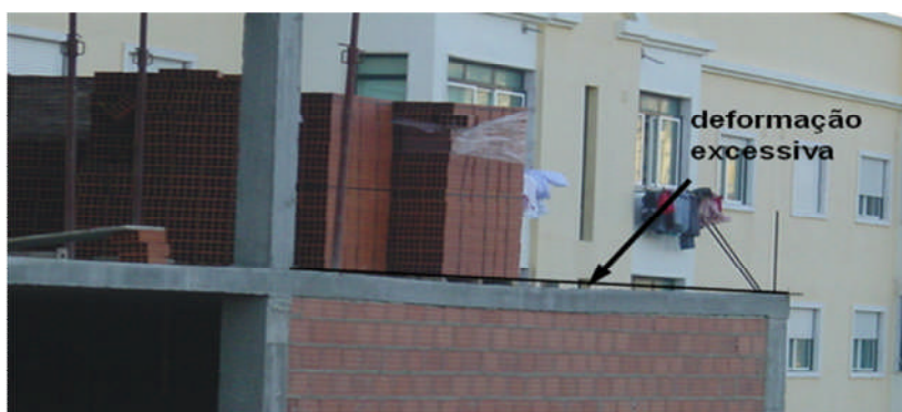
Fig. 6 - Deformação excessiva devido a elevada esbelteza da laje.
