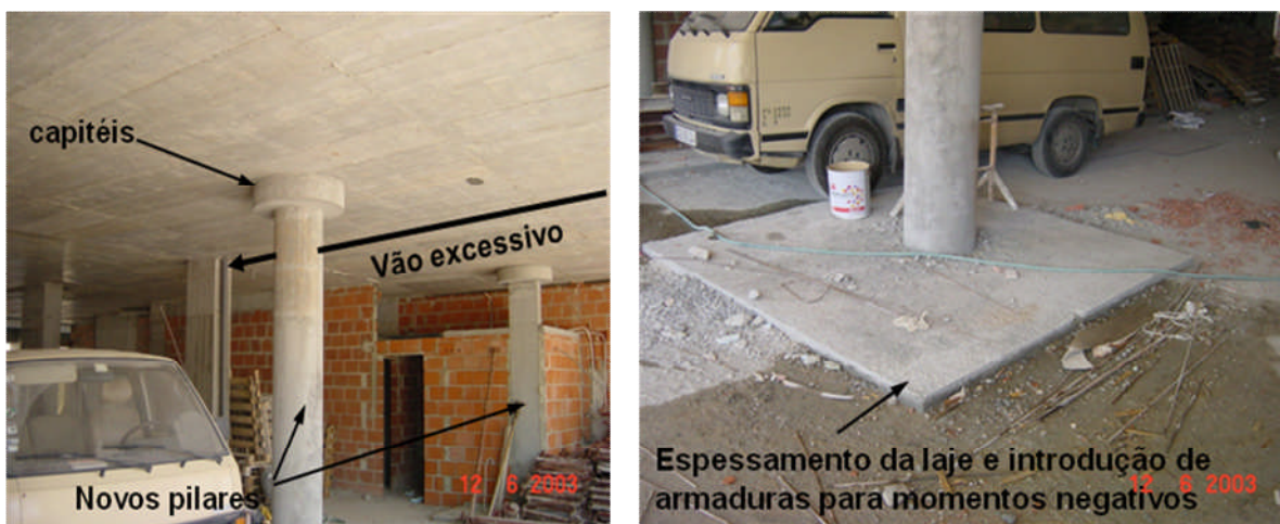
Fig. 12 - Colocação de novos pilares de betão, capitéis e reforço da laje para momentos negativos na zona do novo apoio.
