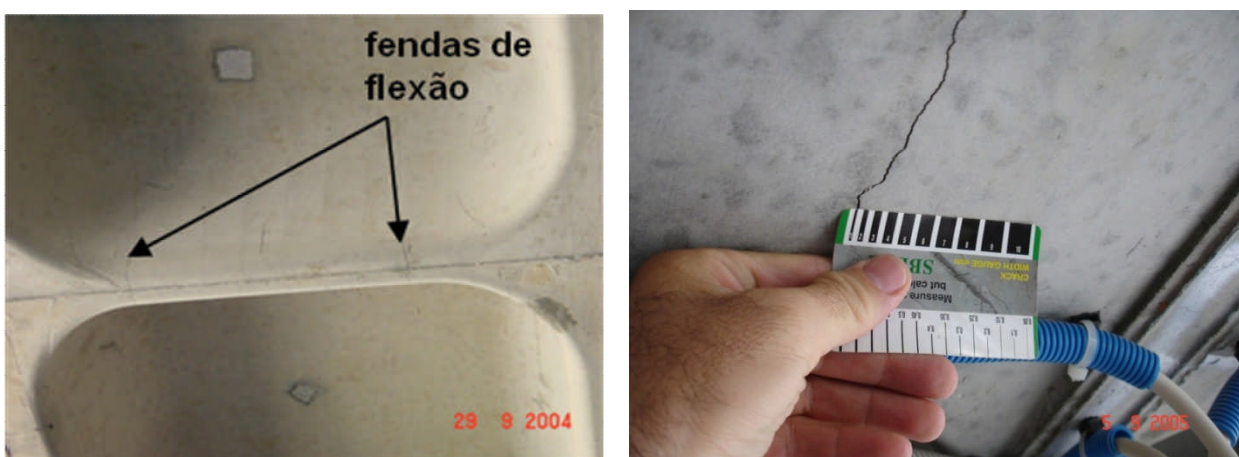
Fig. 8 – Fendilhação numa laje fungiforme nervurada
