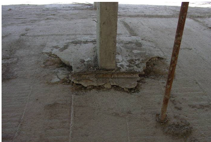
Fig. 2 - Rotura por punçoamento (num edifício em Portugal).
