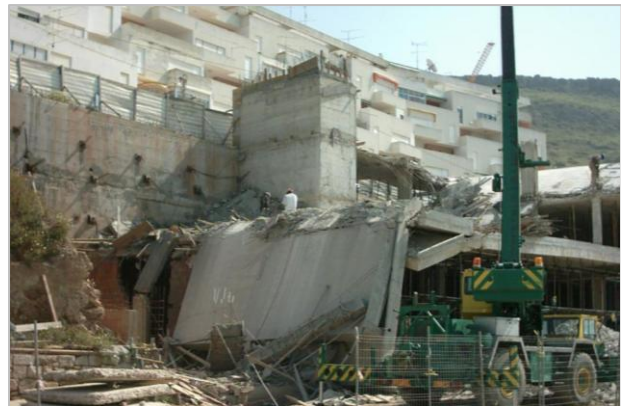
Figura 2: Colapso progressivo de um edifício de laje fungiforme durante a sua construção.
