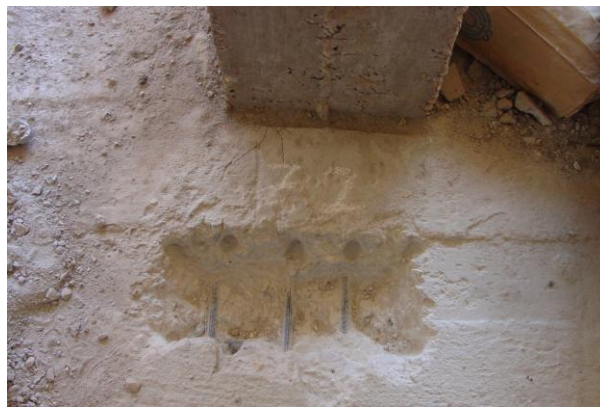
Figura 5: Armadura superior com recobrimento excessivo (reduzida altura útil) em laje fungiforme, e betão com resistência inferior à especificada no projeto.
