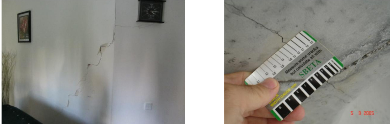
Figura 4: (a) Fendas em paredes divisórias por deformação excessiva da estrutura e (b) fenda com grande abertura numa laje de betão armado.
