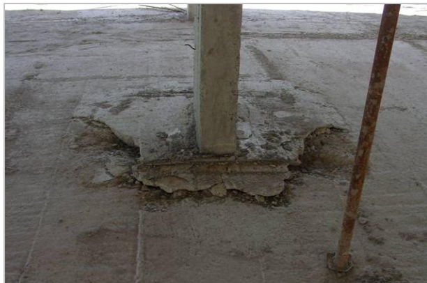
Figura 1: Rotura por punçamento de uma laje fungiforme.
