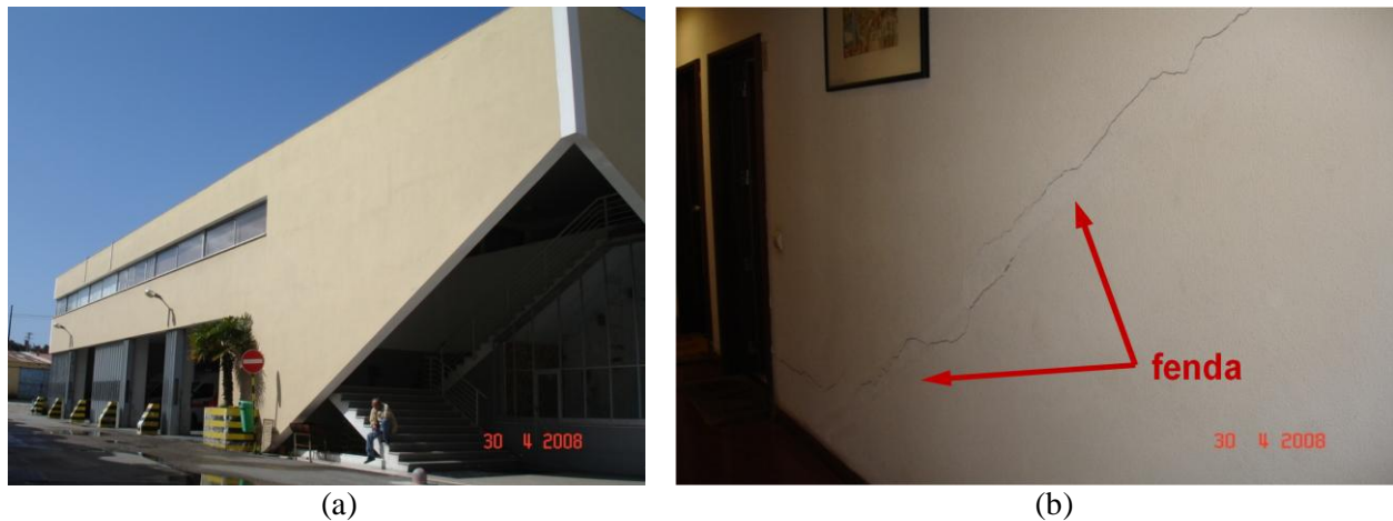
Figura 9: (a) Vista do alçado principal do edifício dos Bombeiros Voluntários da Trafaria; (b) Fendilhação das paredes de alvenaria devido à deformação da laje.
