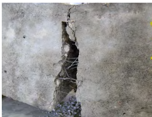
(c) Pormenor da fenda de rotura de uma viga entalhada com fibras.
