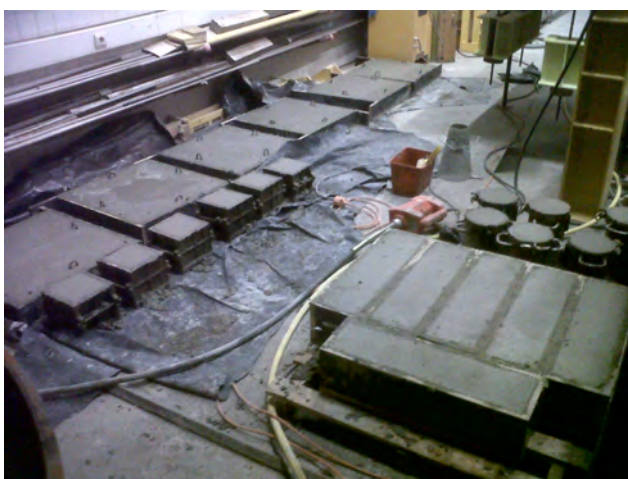
Figura 3.10: Provetes cúbicos, provetes cilíndricos, vigas e painéis de laje nos respectivos moldes no dia da betonagem [16].
