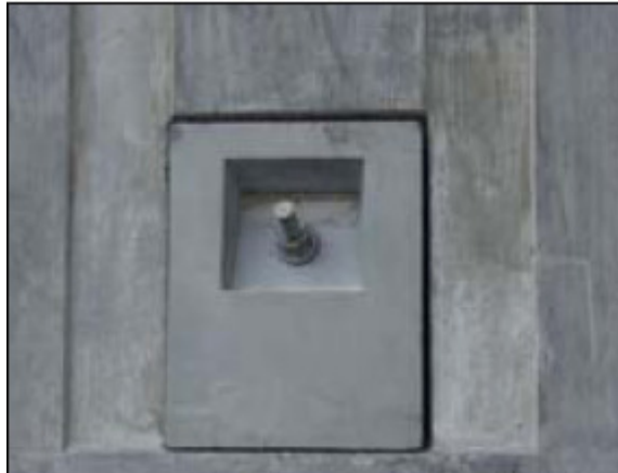
Figura 8.5 - Placa de ancoragem de UHPC instalada no muro de contenção de terras, Perry e Zakariasen, 2003
