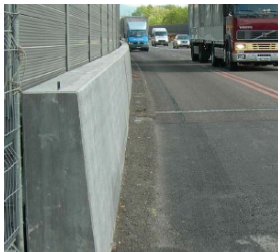
Figura 8. 9 - Barreiras protectoras de embate reabilitadas com UHPRFC, Brühwiler e Denarié, 2008
