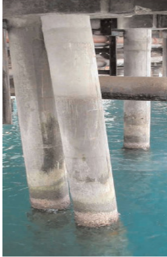
Figura 8. 11 - Elementos de suporte revestidos com UHPC contra a corrosão, Densit
