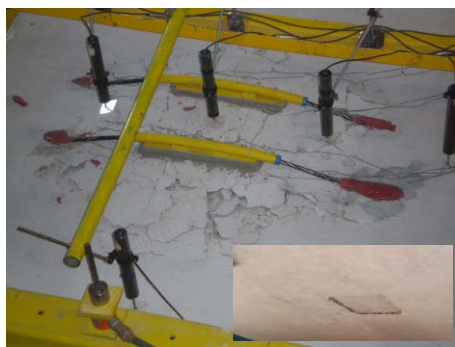
Fig. 15 Aspeto da rotura por punção
