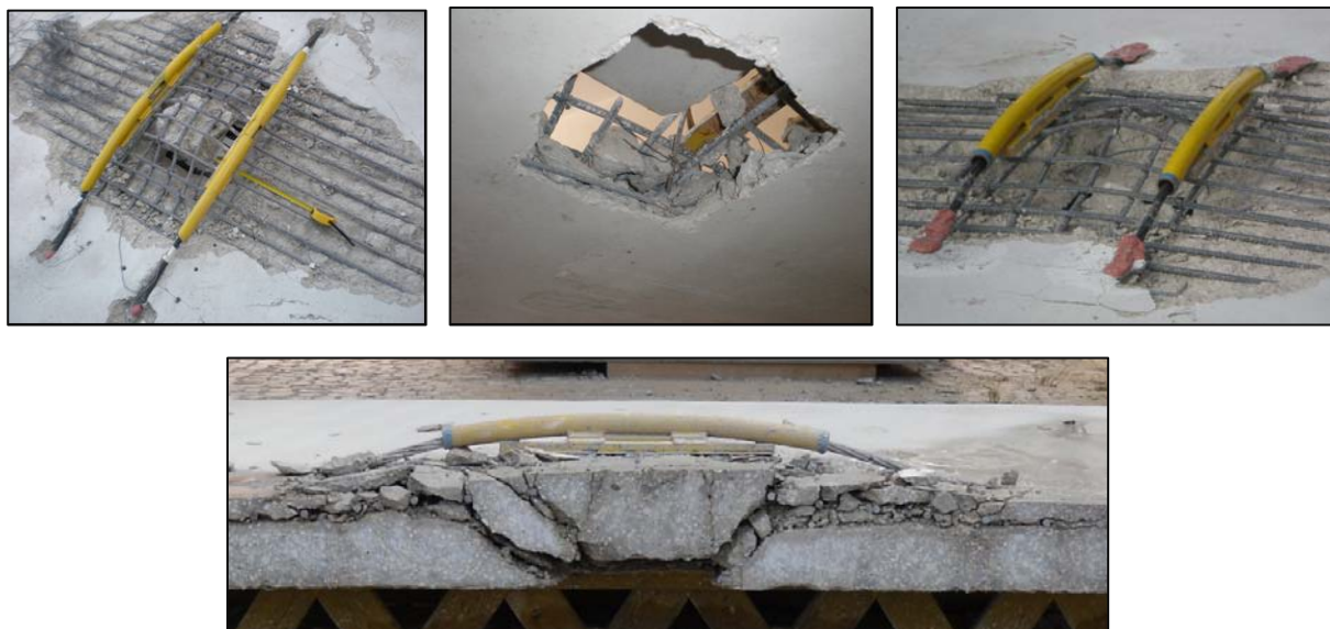
Figura 14: Aspecto de uma laje após colapso [1,5]
